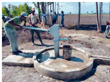
Eine der neuen Wasserstellen
