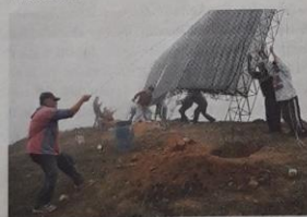
Nebelfänger-Installation in Lima.
