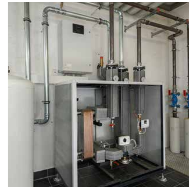
Platzsparend und hoch effizient: die Kompaktwärmestation in dem Gewerbeobjekt, die primärseitig schnell und sicher mit dem System „Megapress S“ an die Vor- und Rücklaufleitung des Fernwärmenetzes angeschlossen werden konnte.
