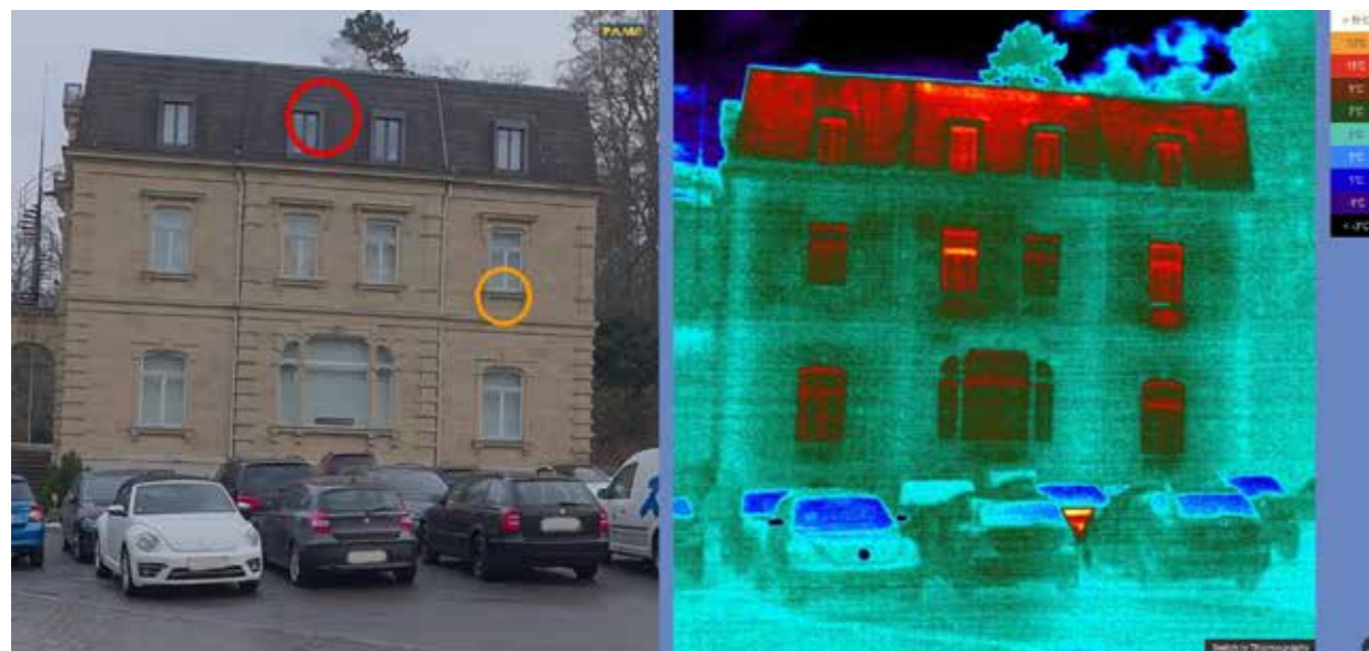
Abbildung 2: Links ist ein Ausschnitt des 100 Megapixel Fotopanoramas und rechts der dazu passende Ausschnitt aus dem 25 Megapixel Thermografiepanorama. Man erkennt die thermischen Schwachstellen am Dach und an den Fenstern, die Fassade ist in Ordnung.
